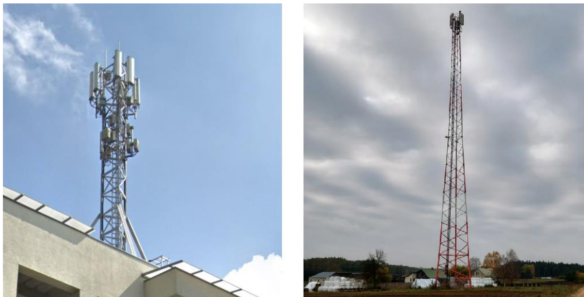
Rysunek 5. Stacje bazowe telefonii komórkowej na dachu budynku oraz wolnostojąca
